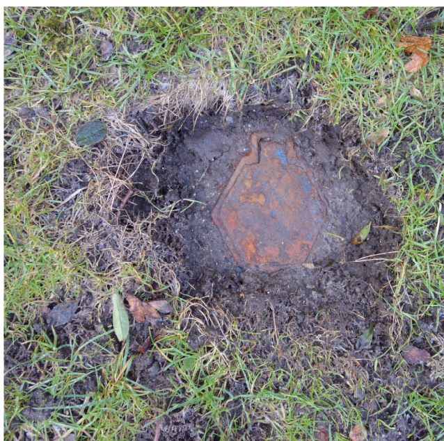
Støbejernsdæksel med underliggende stophane ( plads 3 ).
